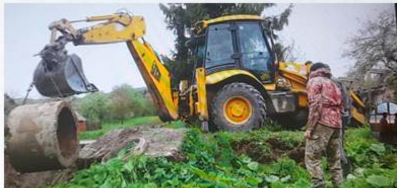
Відновлено міст по вул. Українська, який був пошкоджений в наслідок повені
